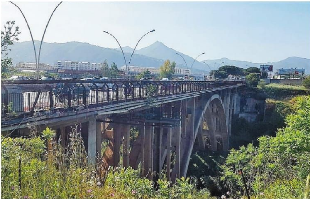
Le verifiche. Ponte Corleone: nell'intesa previsti i fondi per progettare gli interventi di consolidamento
